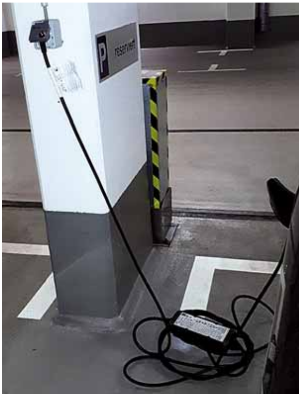
Abbildung 2: Haushaltsübliche Schutzkontaktsteckdose mit eingestecktem Ladegerät – typisches Bild für ein mobiles Ladegerät
