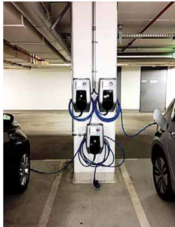
Abbildung 3: Fest installierte Wallbox
